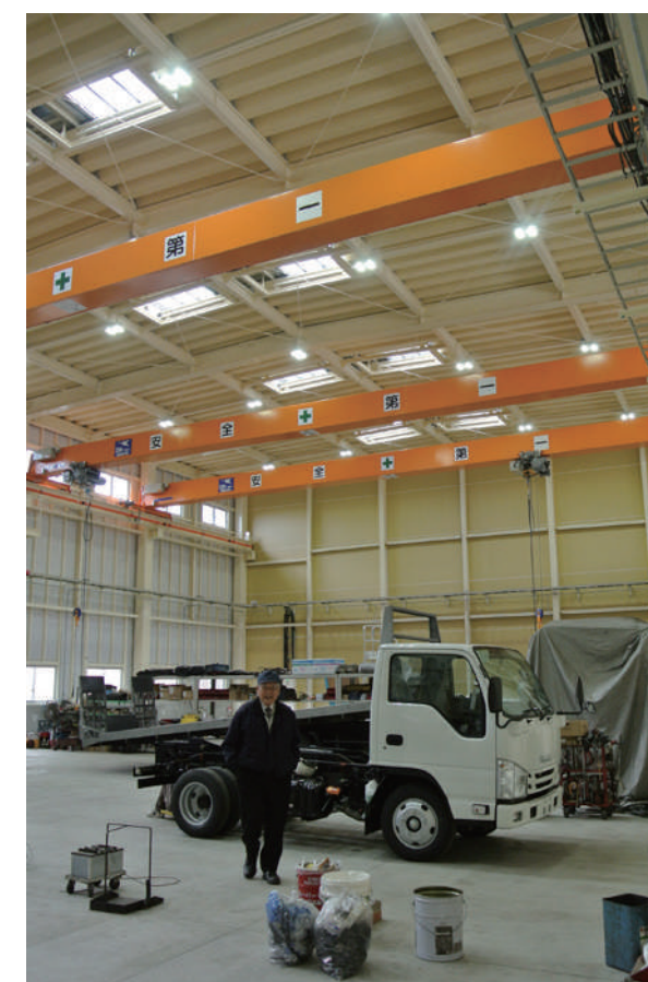
効率的に作業ができる天井走行クレーン。
